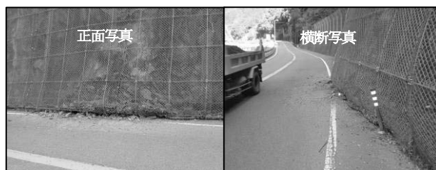
写真-6 法面崩壊前兆写真
