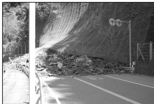
写真-7 法面崩壊写真
