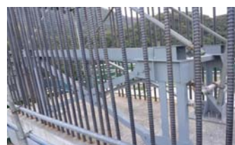
写真-2 鋼製架台
