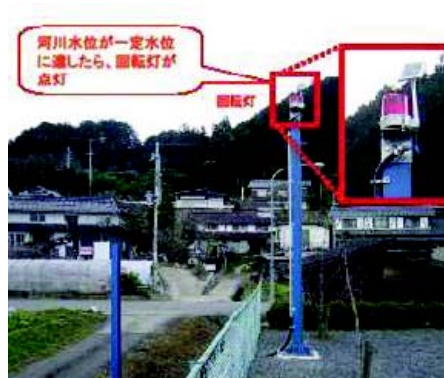
回転灯の設置
