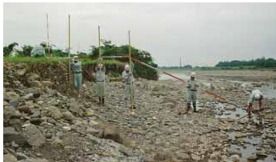
洪水による護岸崩壊 （東温市上村地先： 重信川河口より14.4km付近 東温市南側）
