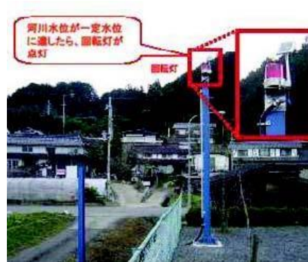
回転灯の設置
