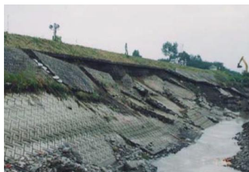
被災状況 （東温市牛湫地先： 重信川河口より14.6km付近 東温市北側）
