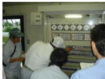
水門の開閉確認
