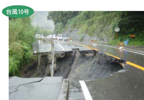
国道32号 車線崩壊[8月1日] (高知県大豊町大久保地先)
