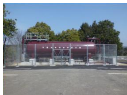
災害に備えた飲料貯水槽
