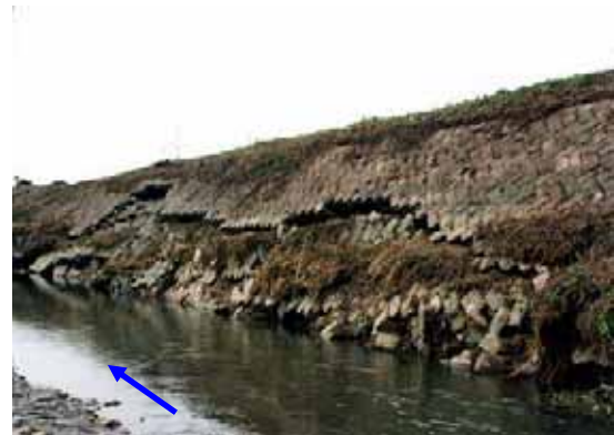
平成 9 年 7 月洪水での護岸崩壊 (松山市古川地先 ふるかわ )
