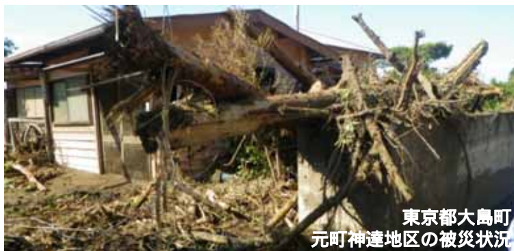
東京都大島町 元町神達地区の被災状況
