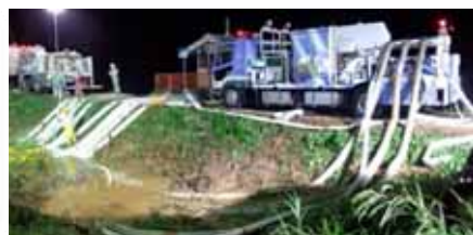
新潟県田上町川坂田排水状況
