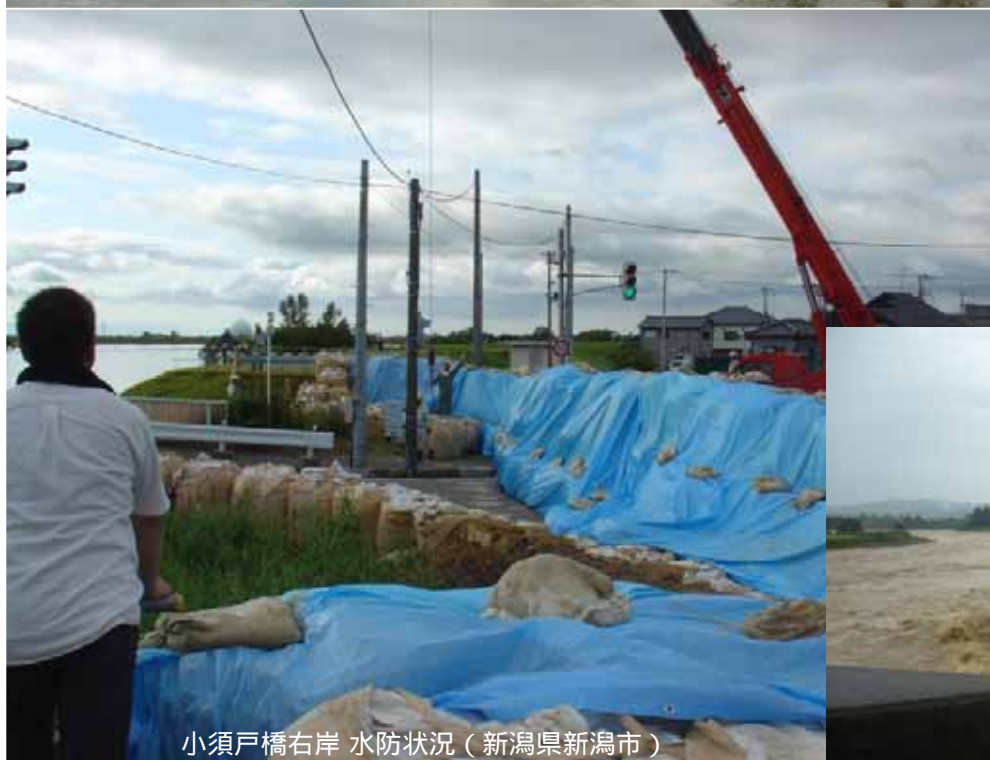
小須戸橋付近 右岸 出水状況 (H23.7.30PM撮影)
