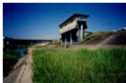
有岡排水機場
