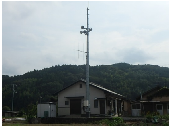
<屋外放送設備>
