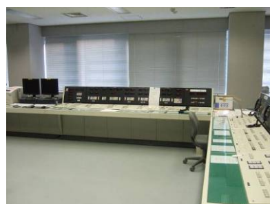
自動制御装置 (他ダム事例)
