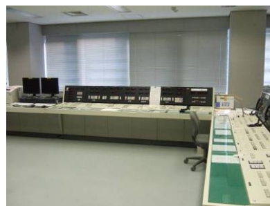
自動制御装置 (他ダム事例)
