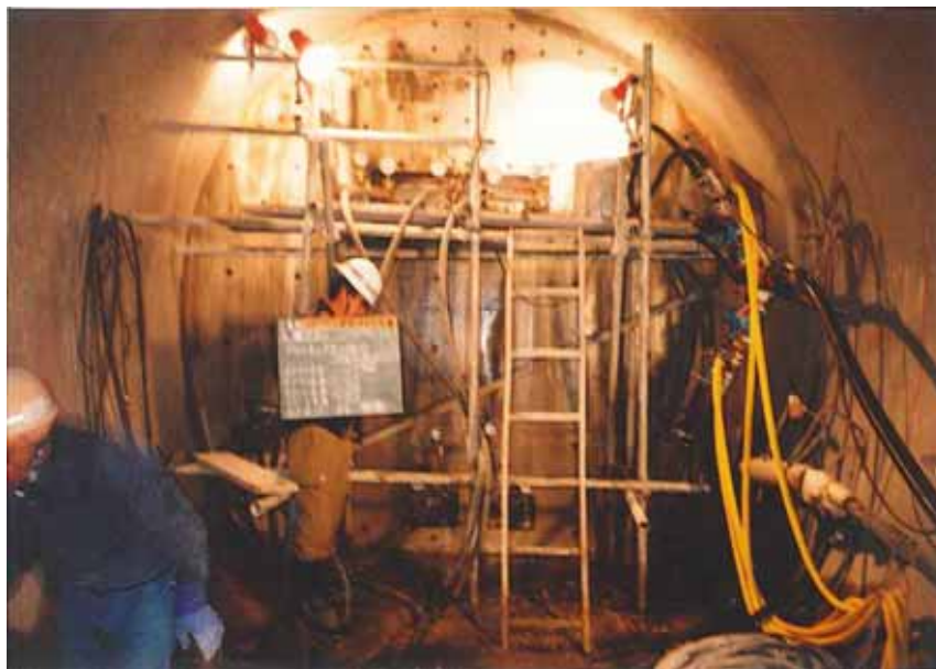
仮排水路閉塞状況
