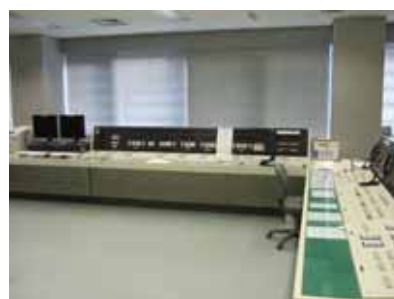
自動制御装置 (他ダム事例)
