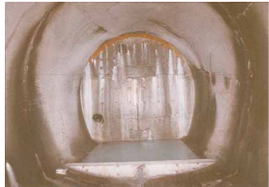
仮排水路閉塞
