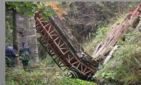
香川・徳島県境無名橋(鋼2径間単純トラス橋)の落橋(2007年)
