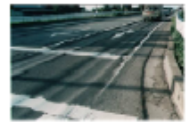
(舗装のわだち割れ)
