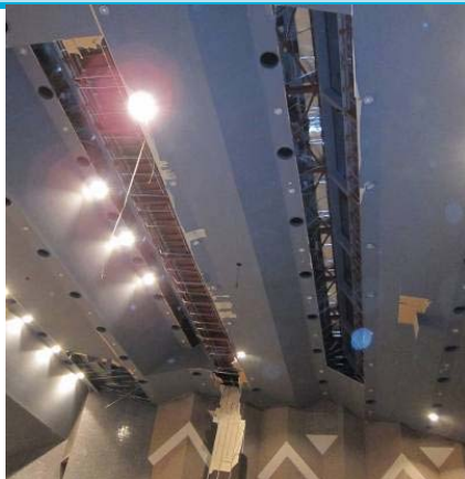
ホールにおける天井の脱落
