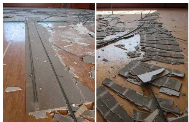
脱落した天井部材
