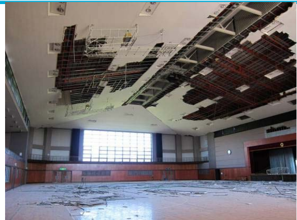
体育館における天井の脱落
