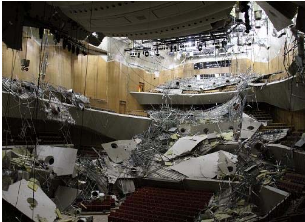
音楽ホールにおける天井の脱落
