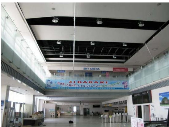
旅客施設における天井の脱落
