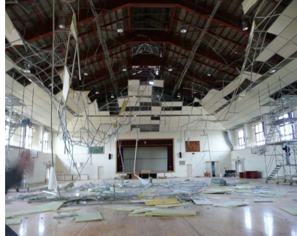
体育館における天井の脱落
