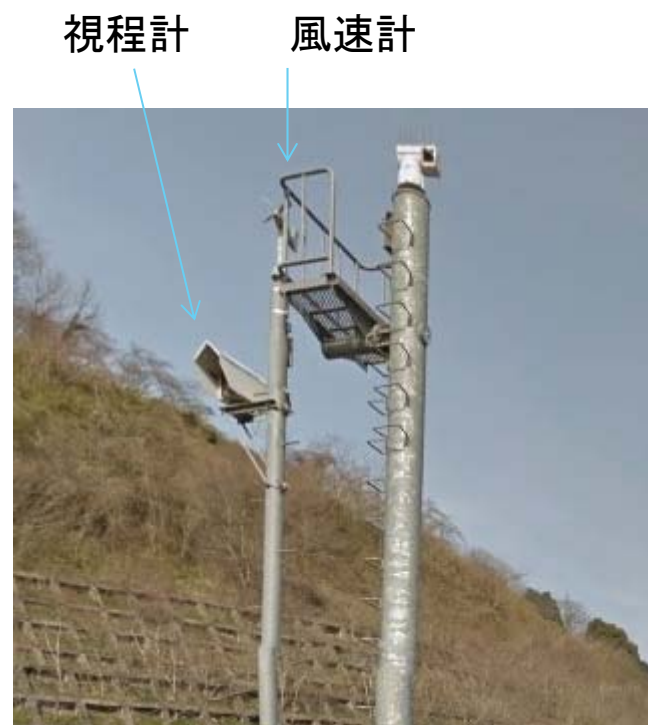
風速計、視程計 大洲道路(愛媛県大洲市)
