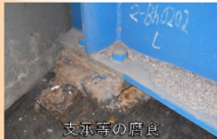
支束等の腐食
