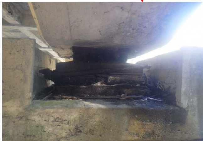
支承部の腐食
