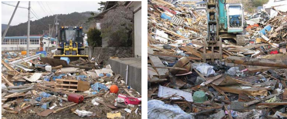
(左)3月15日 綾里地区での瓦礫除去の様子 出典：復興への道_東日本大震災からの復旧記録(岩手県建設業協会) (右)下船渡地区の撤去作業の様子 出典：復興への道_東日本大震災からの復旧記録(岩手県建設業協会)
