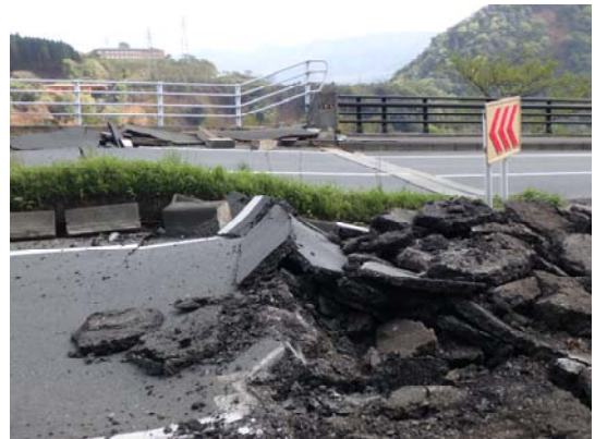
国道 57 号熊本県南阿蘇村 写真提供：香川河川国道事務所
