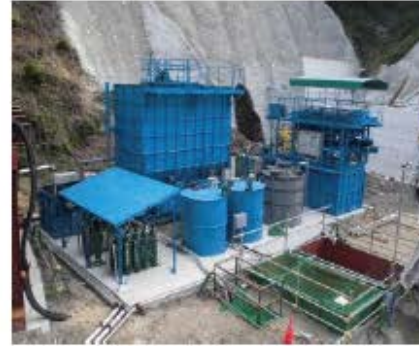
濁水処理設備
