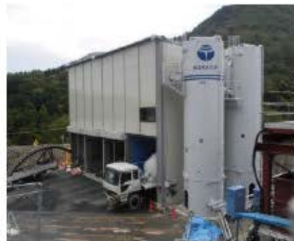
吹付けプラント
