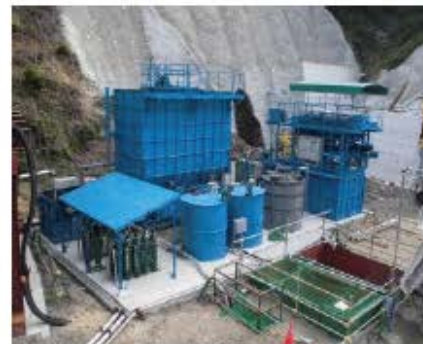
濁水処理設備
