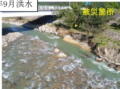
護岸被災状況 (土器川東側 河口より12.0km付近)
