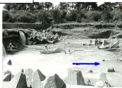
野津床止護床工の洗掘被災(平成2年9月洪水) (土器川 河口より15.4km付近)
