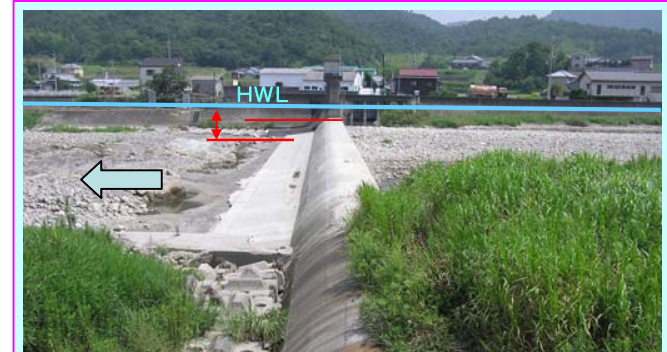
大川頭首工の河積阻害状況
