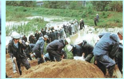
堤防決壊寸前【水防活動状況】 (左岸7.6k付近)
