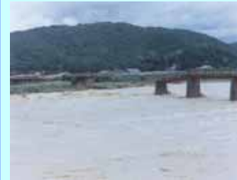
旧乙井橋流出 （11.6k付近）
