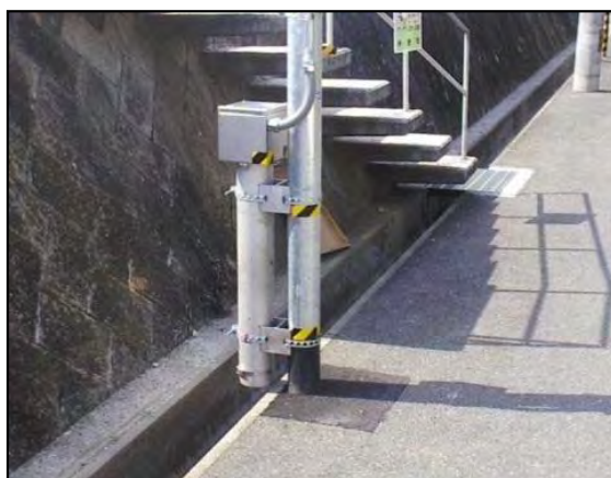
内水センサー設置状況の例 (宇治川)
