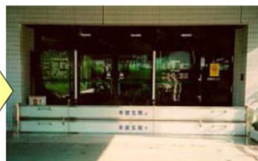
本館玄関への止水板設置状況(設置後) 大洲記念病院の浸水対策 (出典: 中央防災会議 大規模水害対策に関する専門調査会報告)
