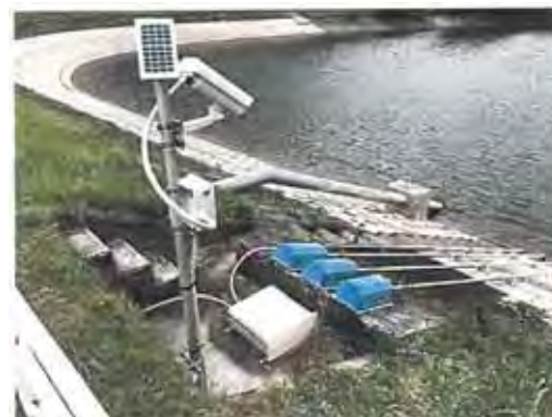
ため池水位計・監視カメラ
