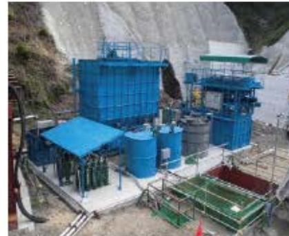
濁水処理設備
