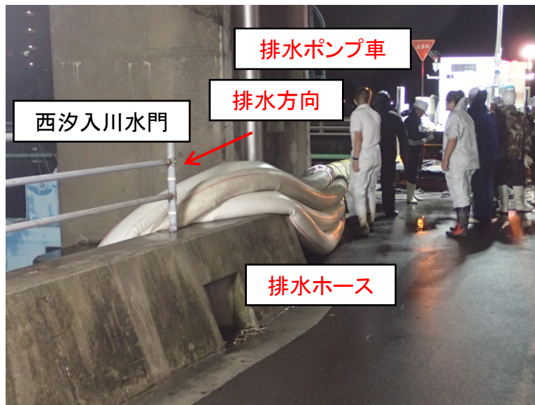
排水ポンプ車稼働状況
