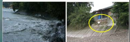
平成17年9月被災状況
