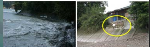
平成17年9月被災状況
