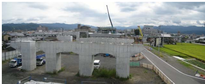
工事の進む まつやまとかんじょう 松山外環状道路 ( まつやま 松山市北井門付近)
