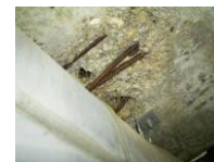
床版剥離・鉄筋露出 国道11号 本山小橋(香川県) 架設後58年経過
