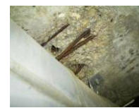
床版剥離・鉄筋露出 国道11号 本山小橋(香川県) 架設後58年経過
