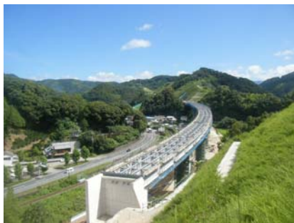
工事の進む四国横断自動車道 (愛媛県宇和島市家藤付近)
