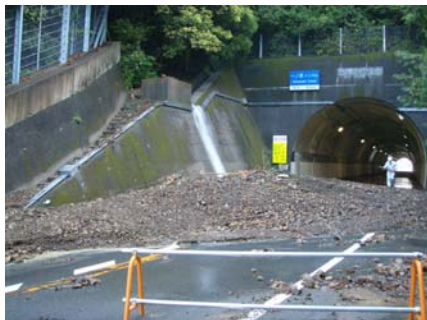
現道部の災害状況 (平成22年度) (徳島市海部郡美波町北河内付近)
