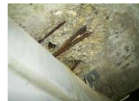
床版剥離・鉄筋露出 国道11号 本山小橋（香川県） 架設後58年経過
