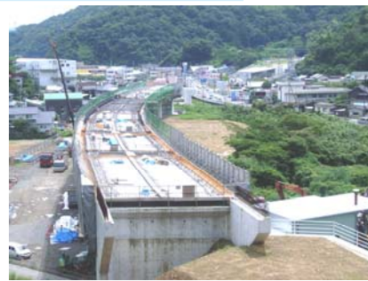
工事の進む四国横断自動車道 （愛媛県宇和島市高串付近）
