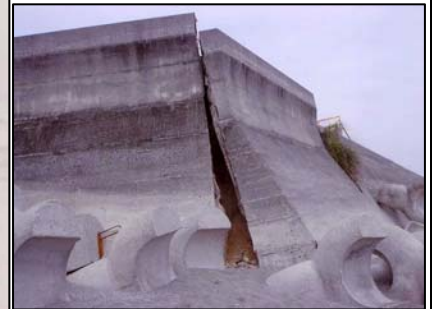
長浜工区H14 被災状況
