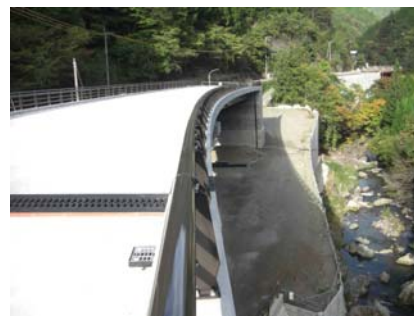
工事の進む地芳道路 (愛媛県上浮穴郡久万高原町西谷地区)
