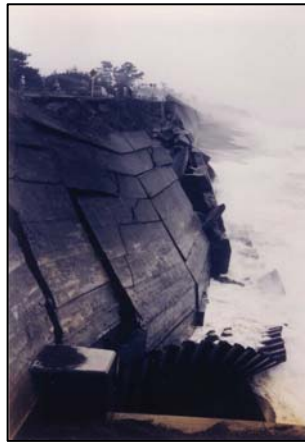
長浜工区H3 被災状況
