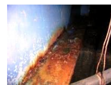
主桁の錆 しもかわ 国道32号 下川橋(徳島県)
