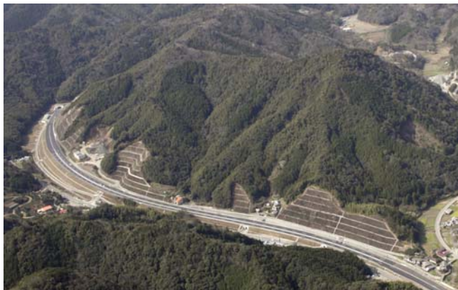
うわじま 工事の進む宇和島道路 うわじま いわいのもり (宇和島市 祝 森 地区)
