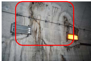
側壁部の コンクリートのひびわれ
