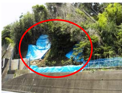
不安定な法面
