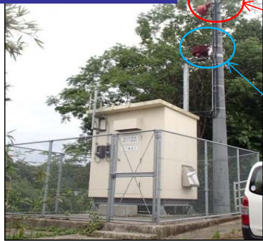
サイレン・スピーカー警報所
