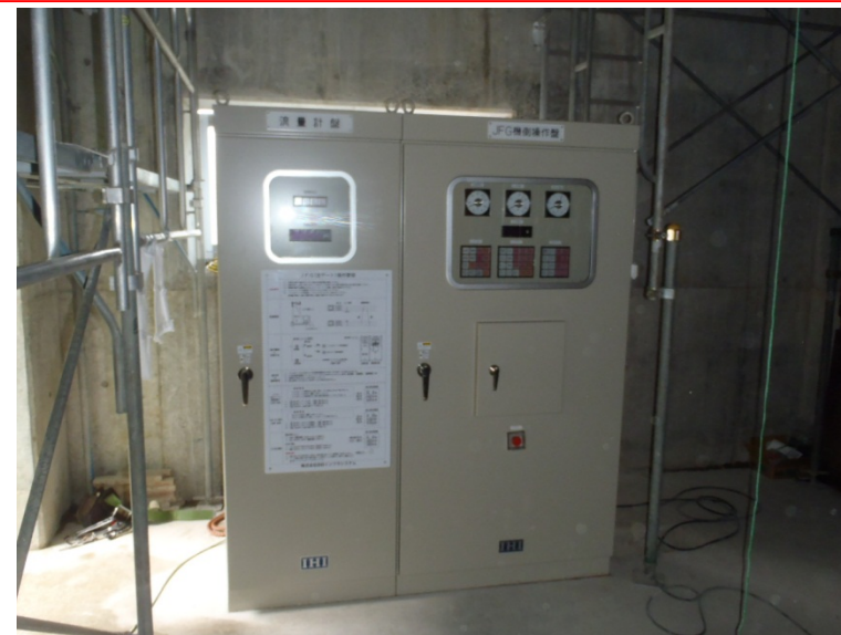
10月14日 低水放流設備完成(機側操作盤)
