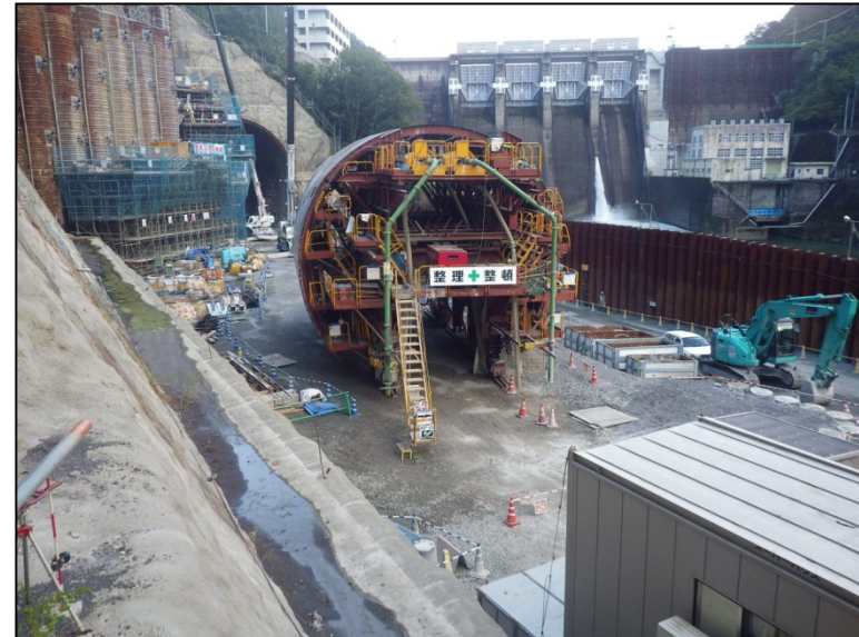
10月27日 深礎アンカー工、調査ボーリング、セントル解体準備
