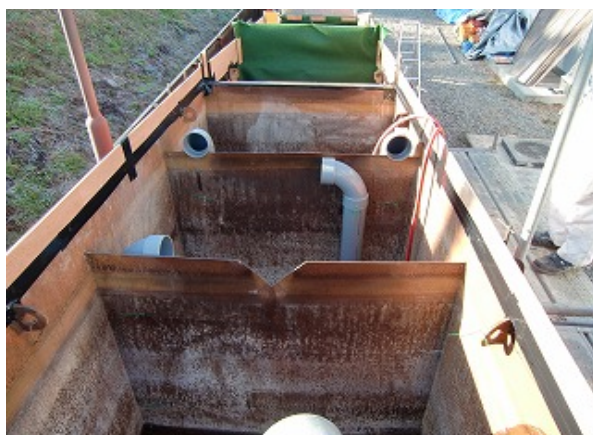
濁水処理システム
