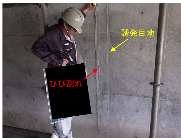
写真 6.1 誘発目地の位置に発生しなかったひび割れの事例
