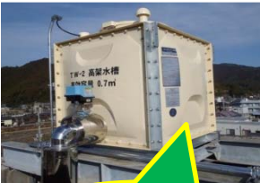
非常用の自家発電設備と高置水槽を設置、避難時に職員が活動するための電力、水を確保！
